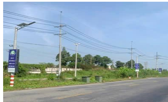
Tuyến đường QL N2 được lắp đặt hệ thống đèn NLMT
